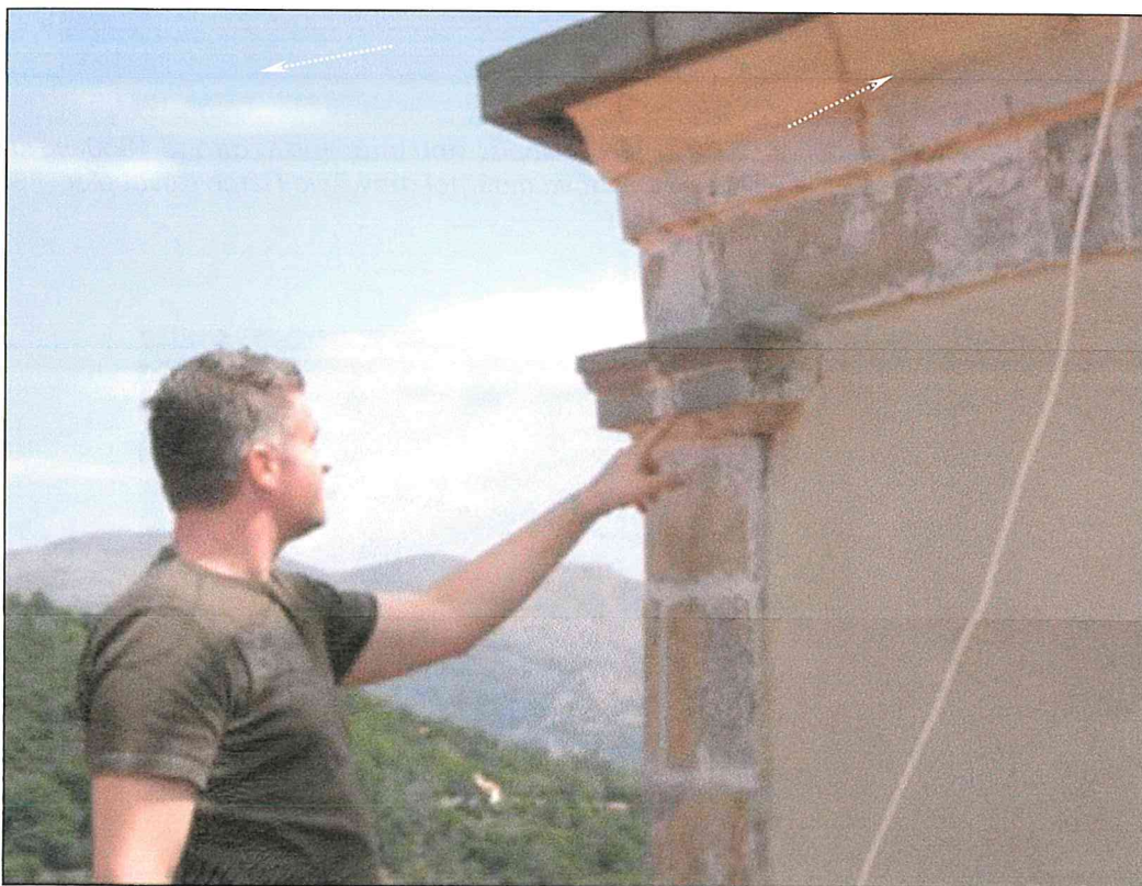
Ρωγμές της τοιχοποιίας του ναού στον τρούλο.
