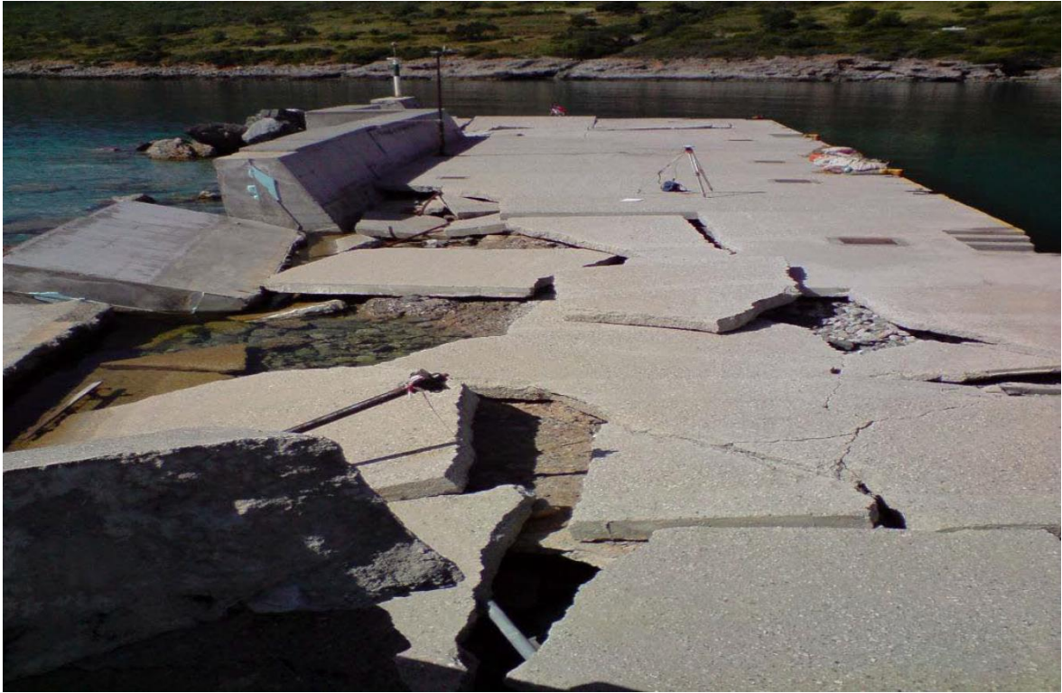
Φωτ. 3: Ζημιές στο κατάστρωμα του υφιστάμενου κρηπιδώματος της εσωτερικής πλευράς.
