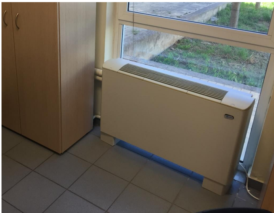
Εικόνα 71 Ενδεικτική μονάδα fan coil του κτιρίου
