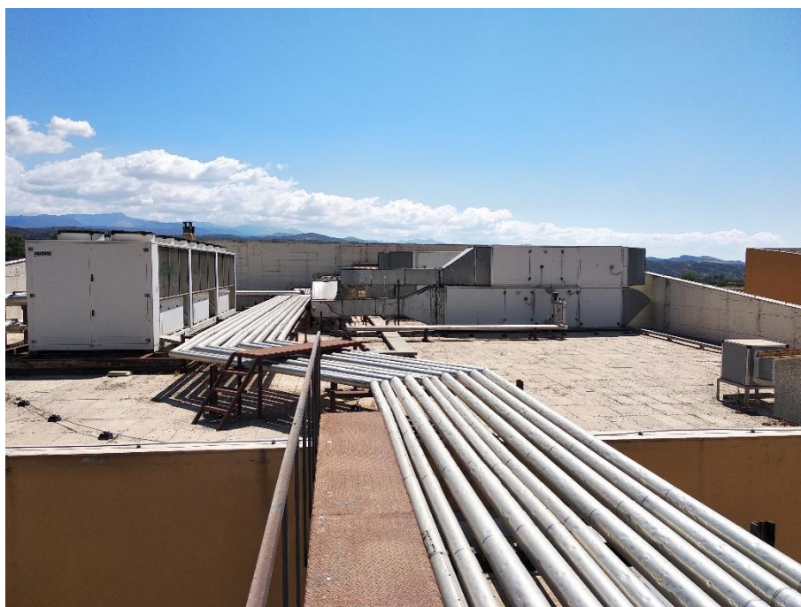
Εικόνα 74 Οι ΚΚΜ στο κτίριο
