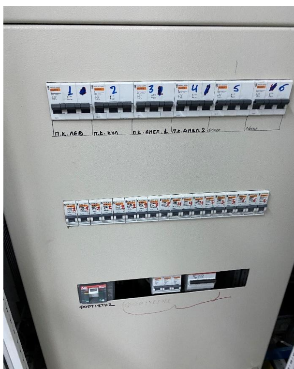
Εικόνα 83 Ηλεκτρολογικός πίνακας του κτιρίου
