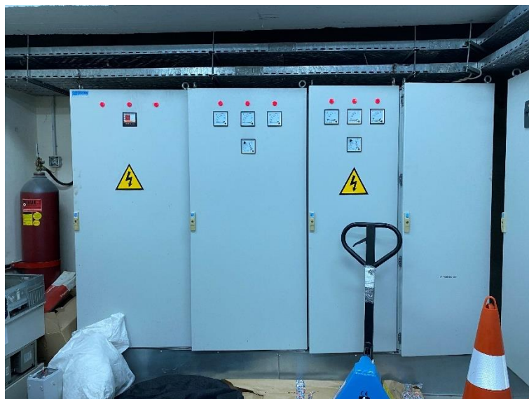
Εικόνα 82 Ηλεκτρολογικός πίνακας του κτιρίου
