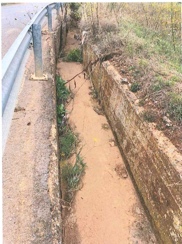
Εικόνα Z3. Υφιστάμενη τάφρος Ζευγολατειού. Είναι κατασκευασμένη στην δεξιά παρειά ΕΟ Νεοχωρίου – Ζευγολατειού / 1
