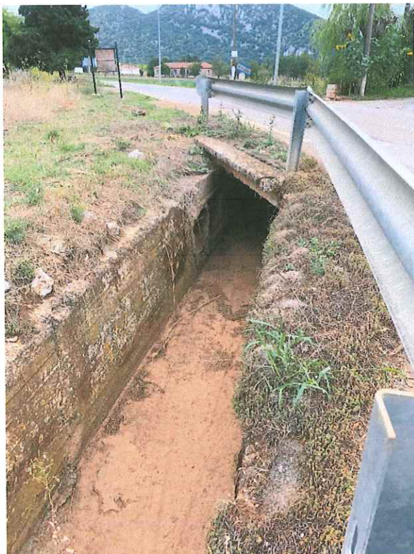
Εικόνα Z2. Ανάντη αρχή Υφιστάμενης τάφρου Ζευγολατειού. Έργο διέλευσης της ΕΟ Τρίπολης – Νεοχωρίου (Εξοδος).
