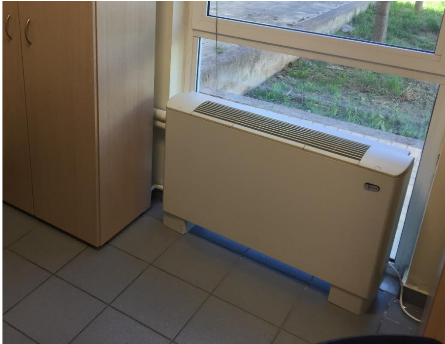
Εικόνα 71 Ενδεικτική μονάδα fan coil του κτιρίου
