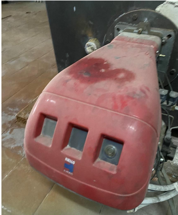
Εικόνα 65 Ο καυστήρας του λέβητα
