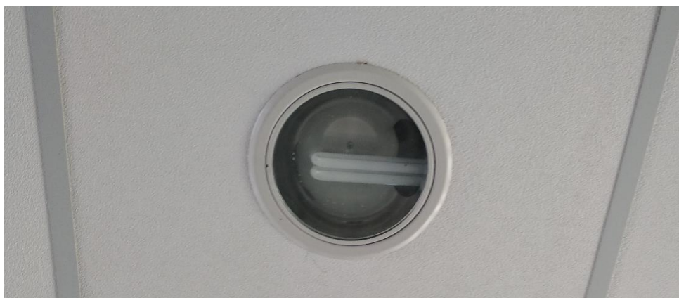
Εικόνα 80 φωτιστικό σώμα Δ
