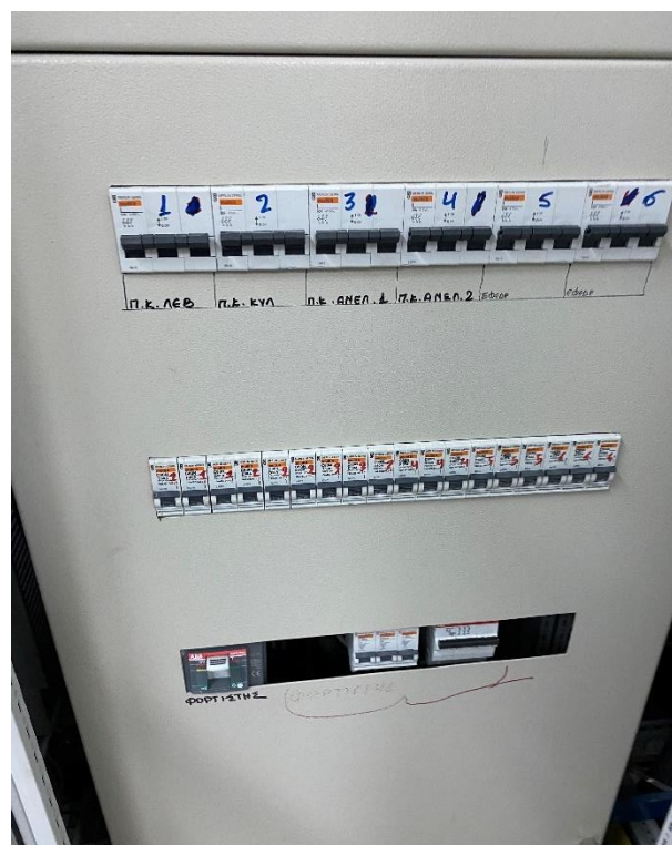
Εικόνα 83 Ηλεκτρολογικός πίνακας του κτιρίου
