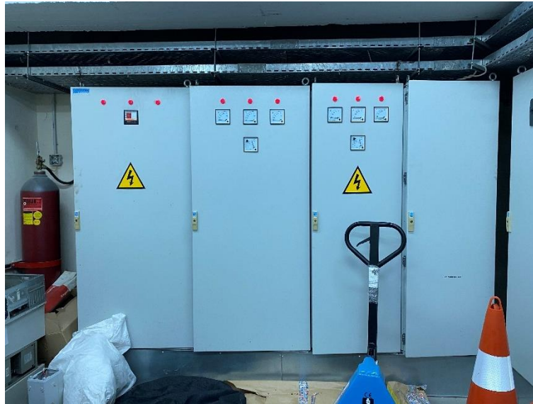
Εικόνα 82 Ηλεκτρολογικός πίνακας του κτιρίου
