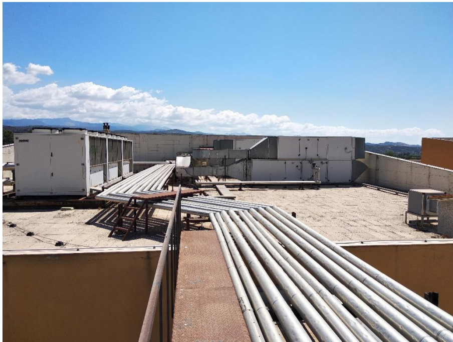
Εικόνα 74 Οι ΚΚΜ στο κτίριο
