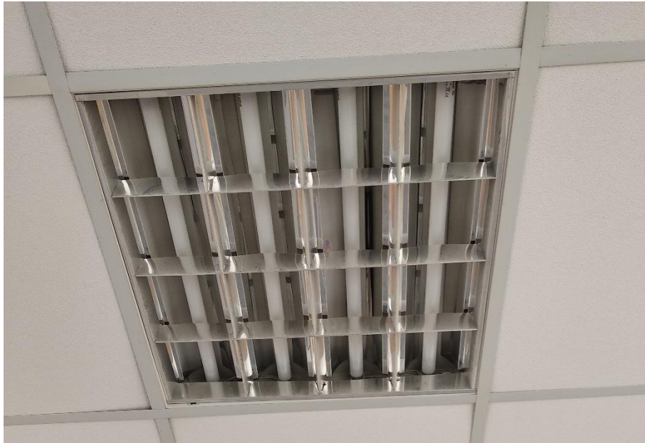
Εικόνα 78 φωτιστικό σώμα Α
