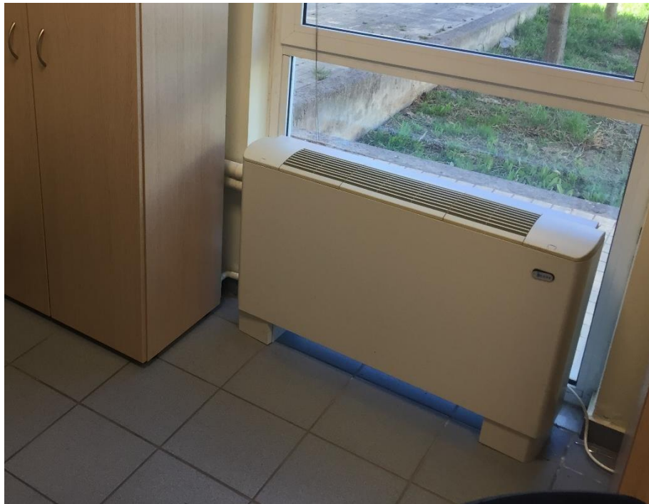
Εικόνα 71 Ενδεικτική μονάδα fan coil του κτιρίου
