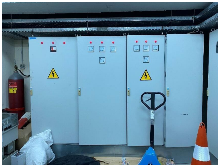
Εικόνα 82 Ηλεκτρολογικός πίνακας του κτιρίου
