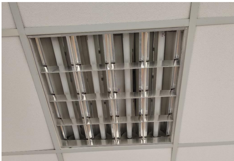
Εικόνα 78 φωτιστικό σώμα Α
