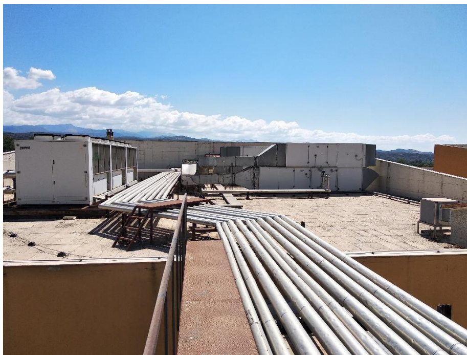
Εικόνα 74 Οι ΚΚΜ στο κτίριο
