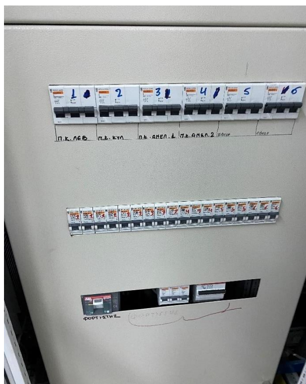
Εικόνα 83 Ηλεκτρολογικός πίνακας του κτιρίου
