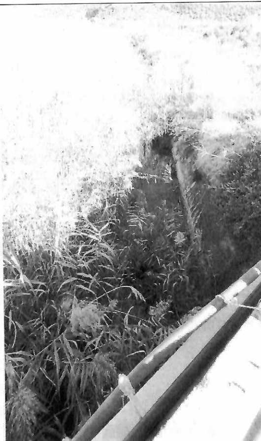
Φωτ. 2 Θέα ανάντη της γέφυρας. Έντονη βλάστηση και στάσιμο νερό.
