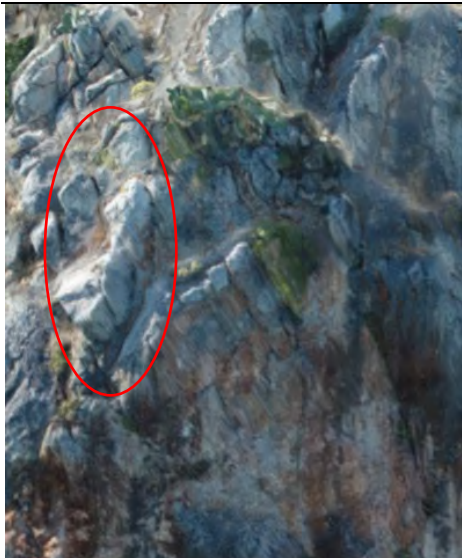
Άποψη του πρανούς N1 όπου σημειώνεται με κόκκινο δυνητική ολίσθηση τεμάχους
