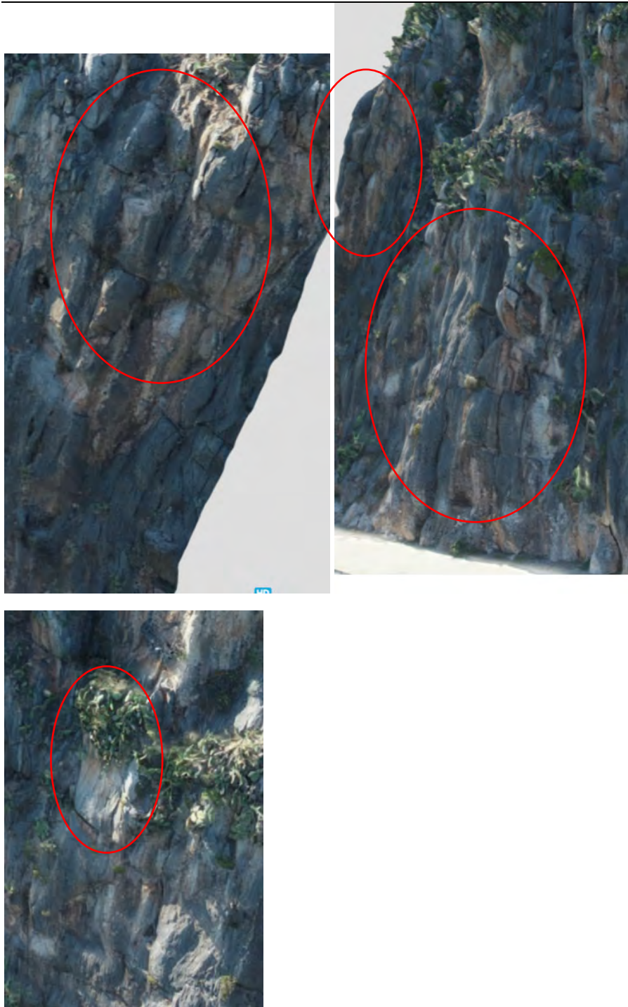
Άποψη του πρανούς N5 όπου σημειώνεται με κόκκινο δυνητικές ολισθήσεις τεμαχών
