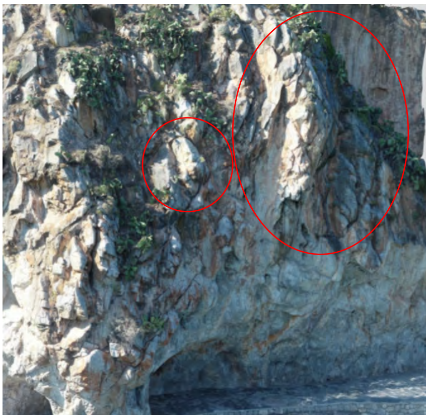
Άποψη του πρανούς N3 όπου σημειώνεται με κόκκινο δυνητικές ολισθήσεις τεμαχών
