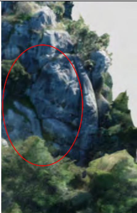
Άποψη του πρανούς B1 όπου σημειώνονται με κόκκινο δυνητικές ολισθήσεις τεμαχών
