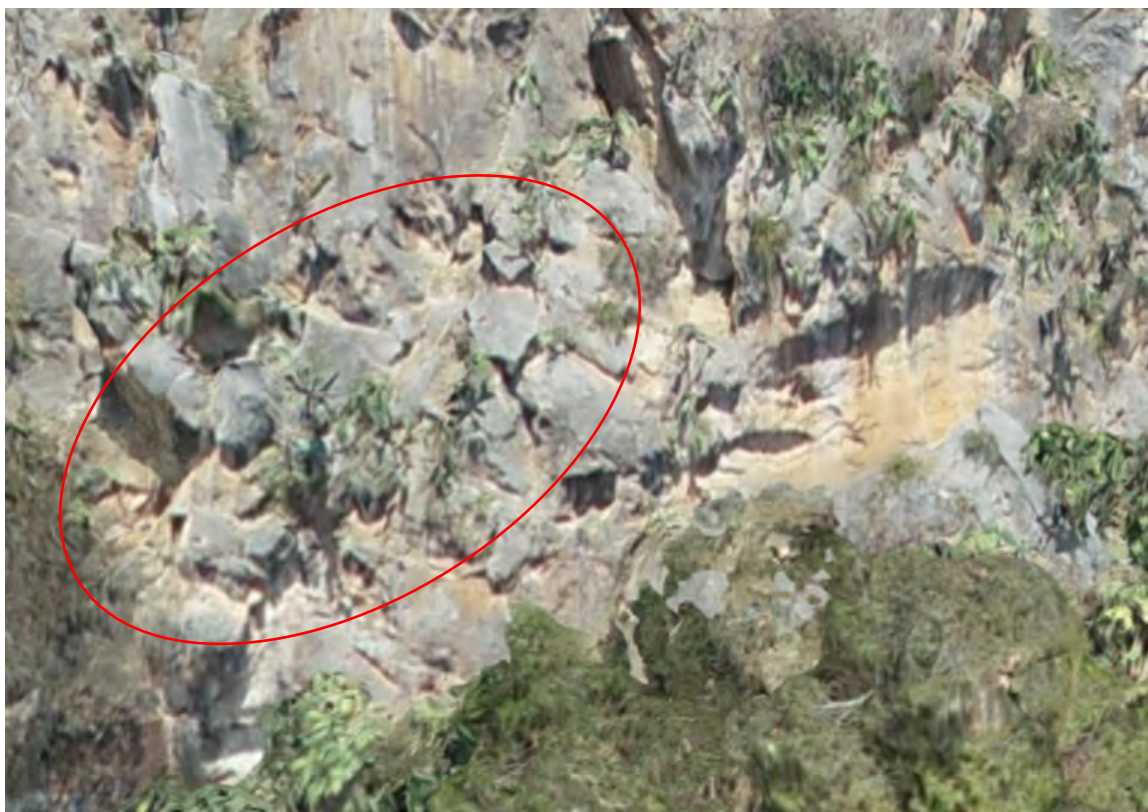
Άποψη του πρανούς N10 όπου σημειώνονται με κόκκινο δυνητικές ολισθήσεις τεμαχών
