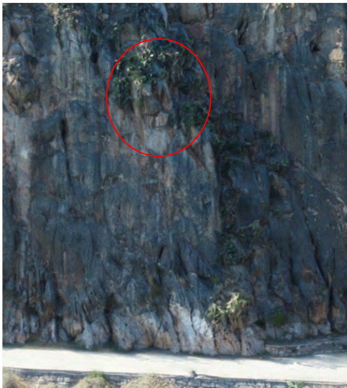
Άποψη του πρανούς N4 όπου σημειώνεται με κόκκινο δυνητικές ολισθήσεις τεμαχών
